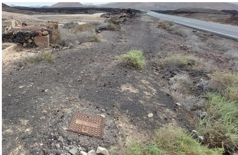
Figura 51. Arqueta abastecimiento de agua, LZ-703. Fuente: Elaboración propia.
