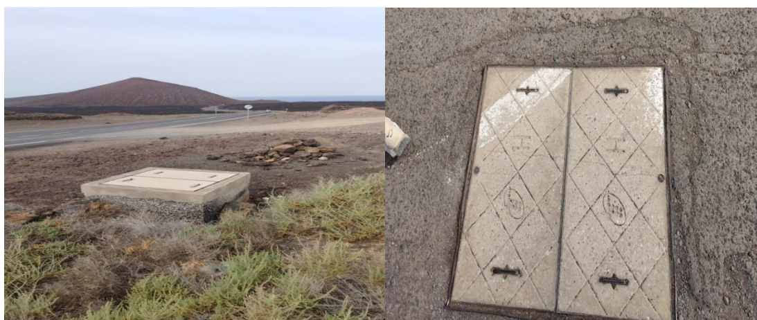
Figura 57. Arquetas Telecomunicaciones, El Golfo. Fuente: Elaboración propia.
