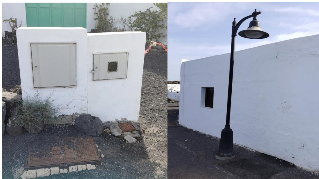
Figura 53. Arqueta red eléctrica y alumbrado público, en El Golfo. Fuente: Elaboración propia.
