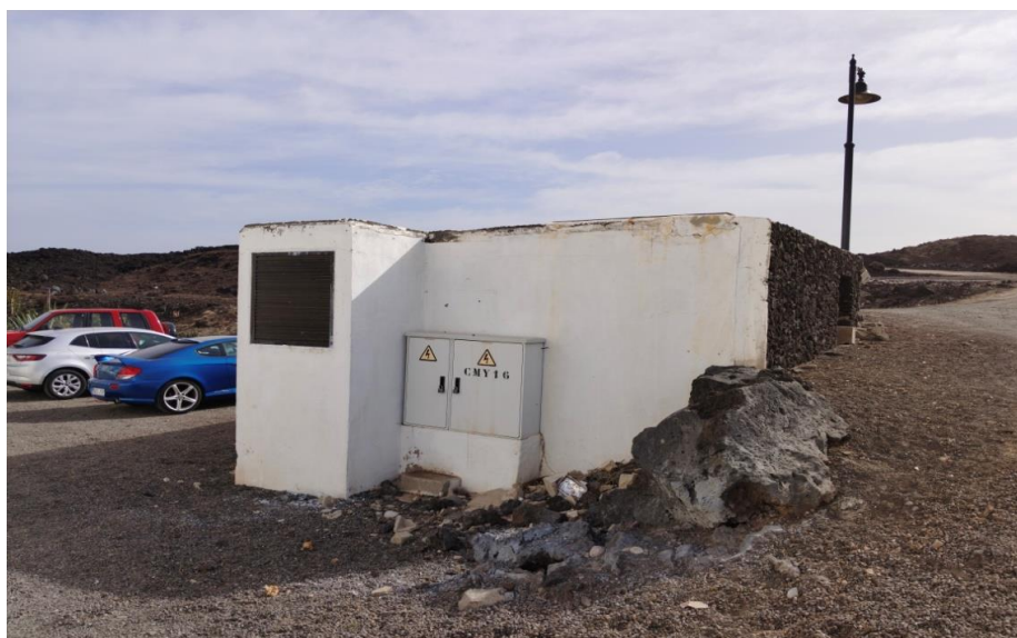
Figura 54. Centro de transformación en Calle Marangalla en El Golfo. Fuente: Elaboración propia.
